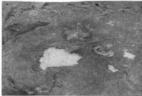
Дефекты от слущивания скал
